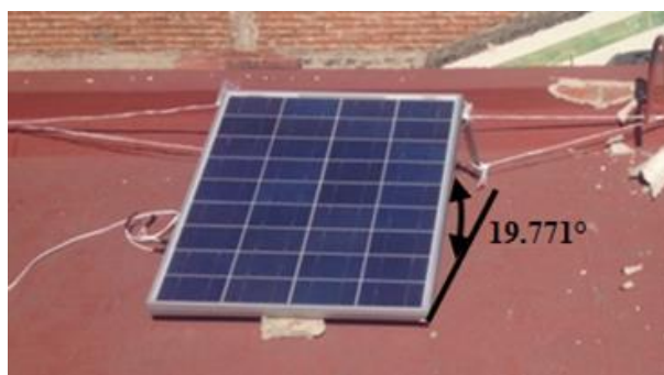
Figura 8. Sistema fotovoltaico fijo
